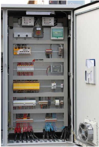
Bild 2: In Griechenland können die Schaltschranktemperaturen 60 °C und mehr erreichen – die eingesetzten HIMatrix-Module mit erweitertem Temperaturbereich sind für Temperaturen bis 70° C ausgelegt.
